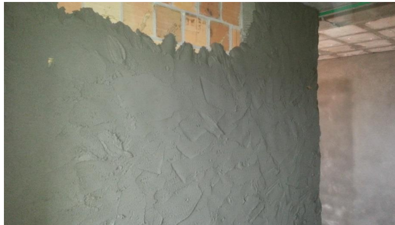
Figura 2: Aplicação de argamassa em parede sem chapisco.
